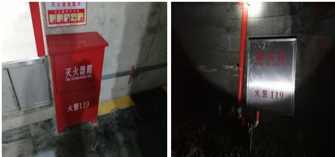
图 2.4-36 灭火器及消火栓
