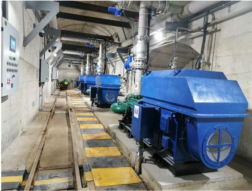
图 2.4-31 北副井-610m 泵房排水泵
