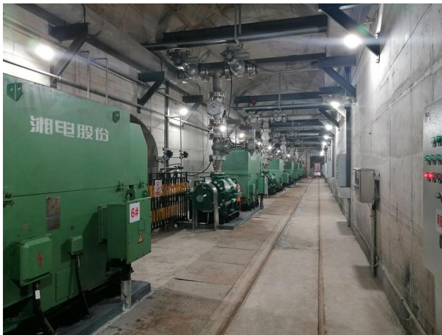
图 2.4-32 三期副井-660m 泵房排水泵
