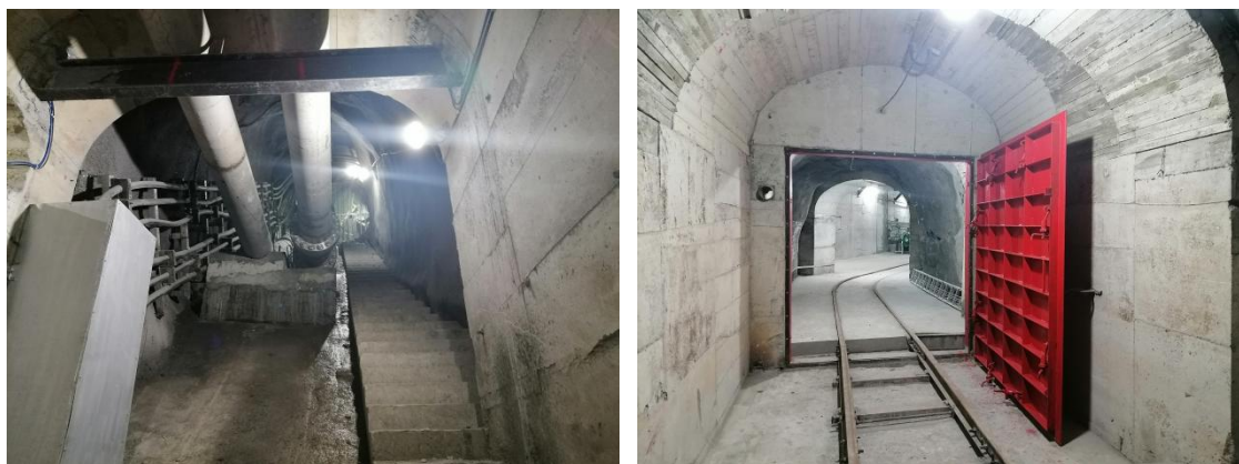
图 2.4-10 南矿带-660 排水系统安全出口
