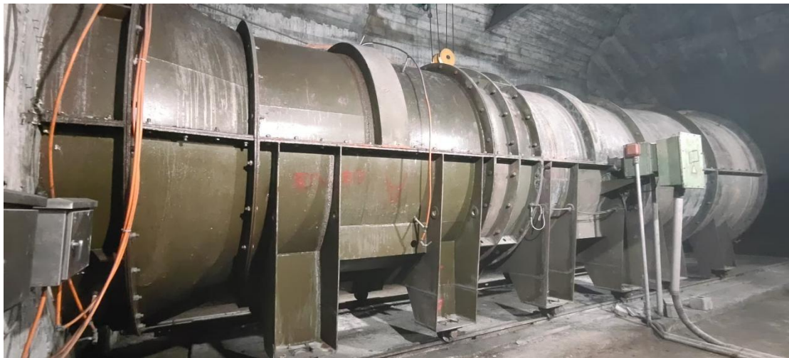
图 2.4-23 北西风井-460m 中段风机
