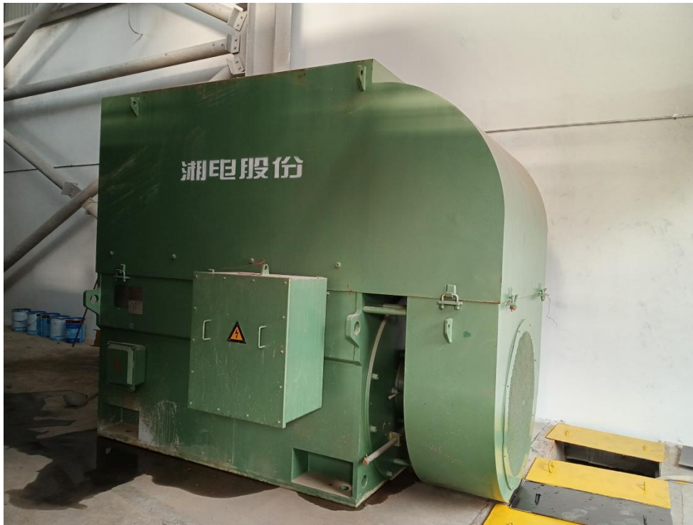
图 2.4-24 三期回风井风机备用电机
