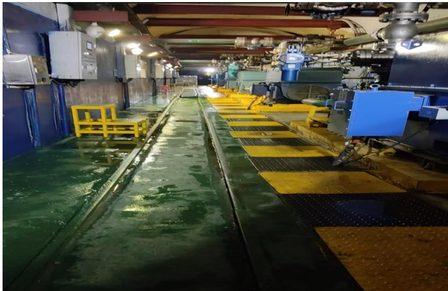
图 2.4-30 北副井-460m 泵房排水泵
