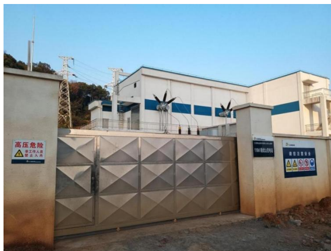
图 2.4-37 三期新建 110kV 总降压站
