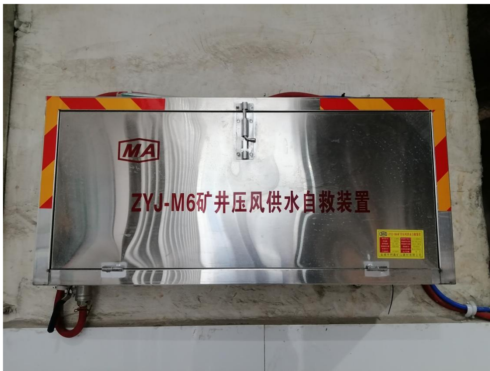
图 2.4-45 压风供水自救装置
