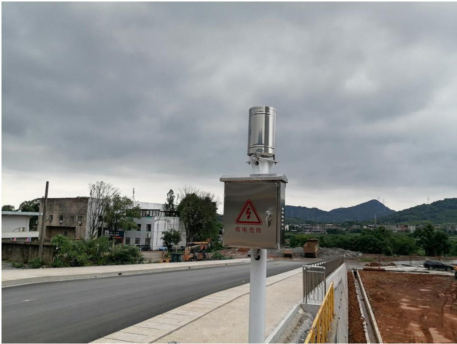
图 2.4-29 降雨量观测站
