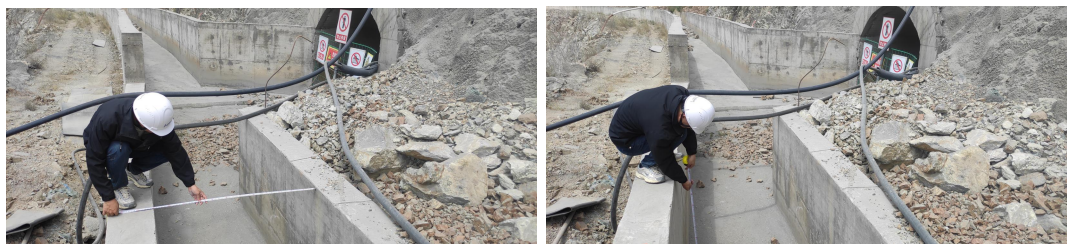
图 2.4.6-6 1750m 平台东侧截排洪沟
