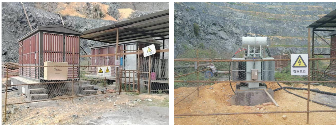
图 2.4.7-1 1690m 平台箱式变电站
