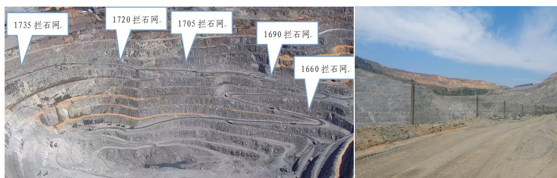
图 2.4.4-14 运输道路上方拦石网设施
