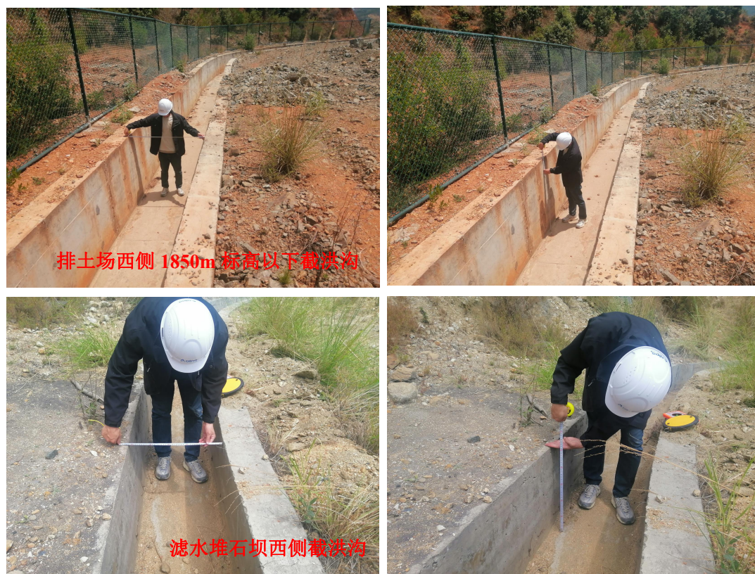
图 2.4.2-10 西侧下部截洪沟现状
