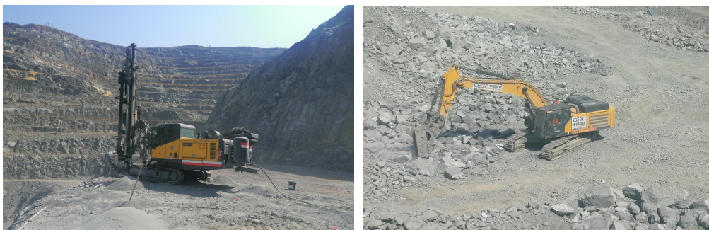
图 2.4.4-8 采场穿孔破碎设备
