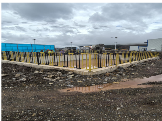
初期雨水收集池
