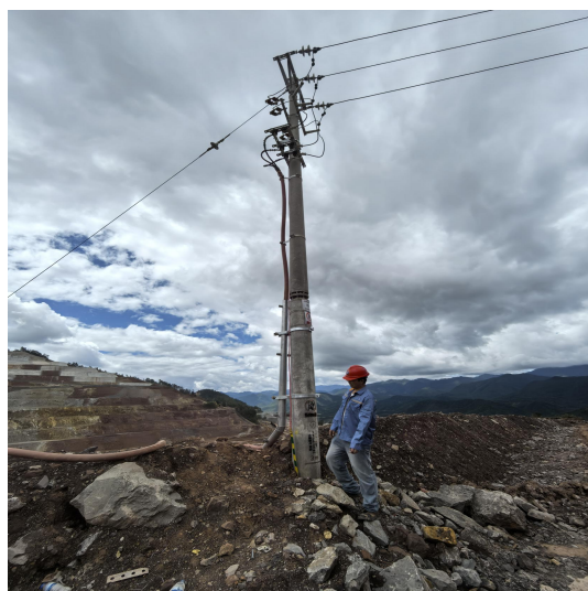
场地内 6kV 架空线路
