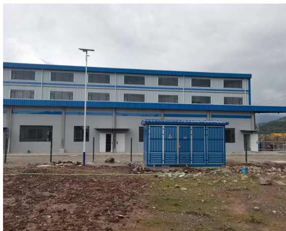
机修车间变电所
