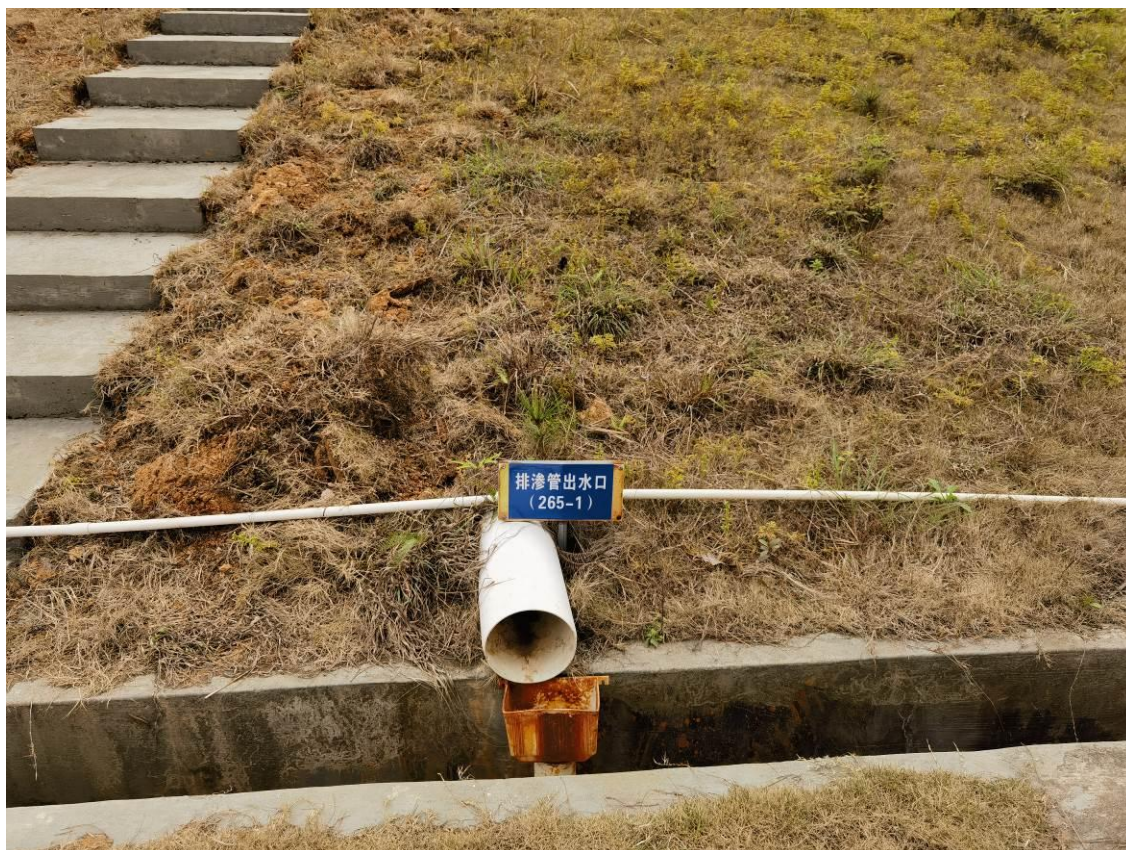
图 2.4-7 排渗管出水口
