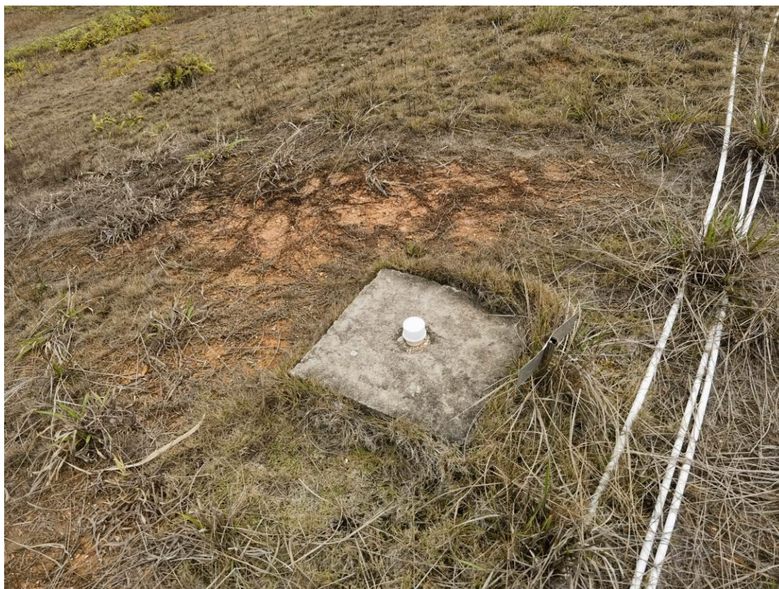
图 2.4-11 浸润线观测设施
