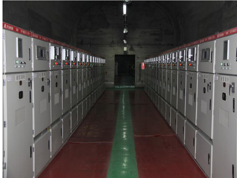
图 2-7 -330m 井下中央变电所
