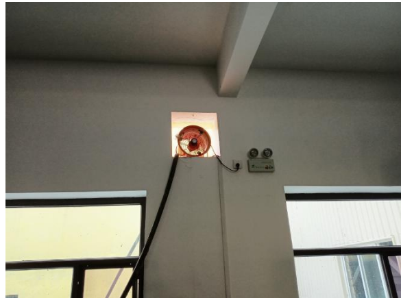
应急照明灯具及机械通风设施
