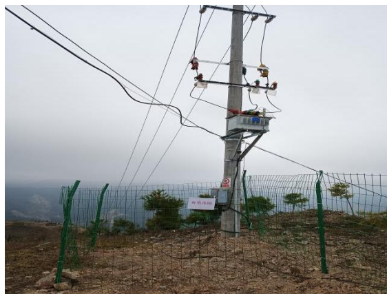
30kVA 杆上照明变压器
