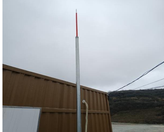
边坡雷达系统防雷设施
