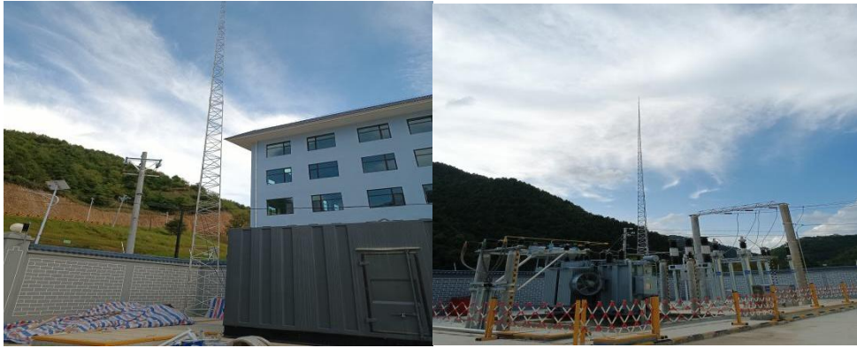
图 2.4-20 35kV 变电站防雷设施
