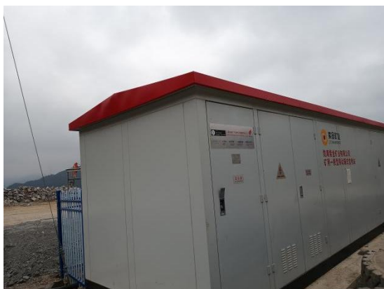
采场工业场地变电站
