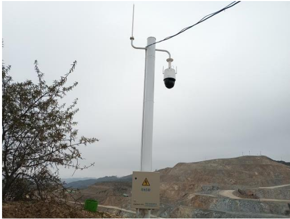
采场视频监控避雷设施
