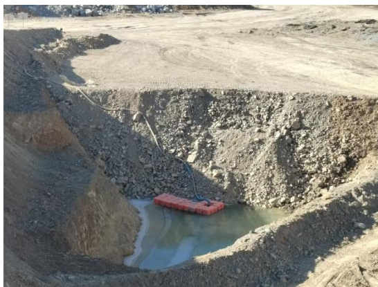
采场排水泵排水
