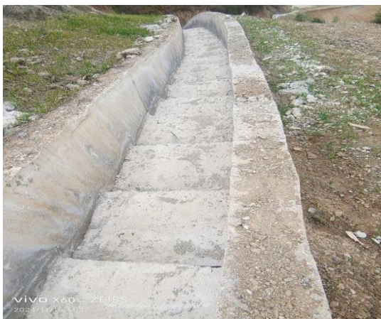
陡坡段排土场截水沟（1m×1m）
