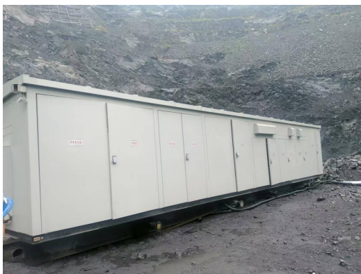
图 2.4.8-1 排水设施箱式变电站
