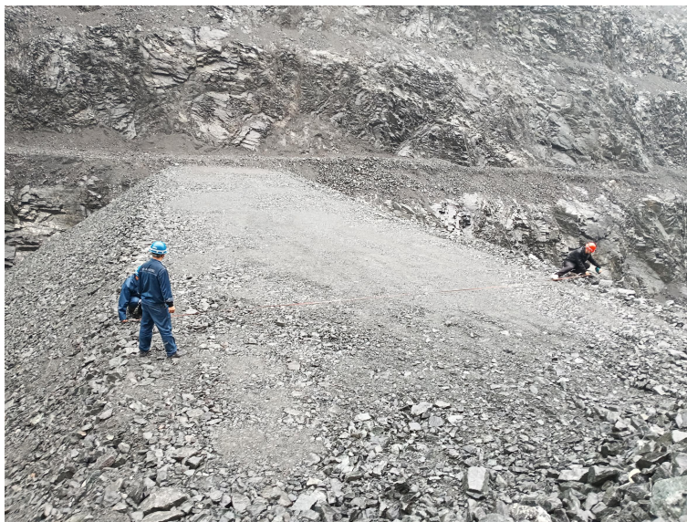
图 2.4.2-3 拦挡坝现场图
