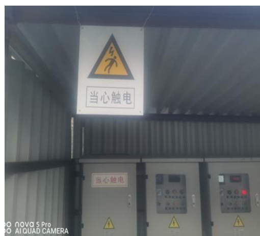
图 2.4.11-6 箱式变电站警示标志
