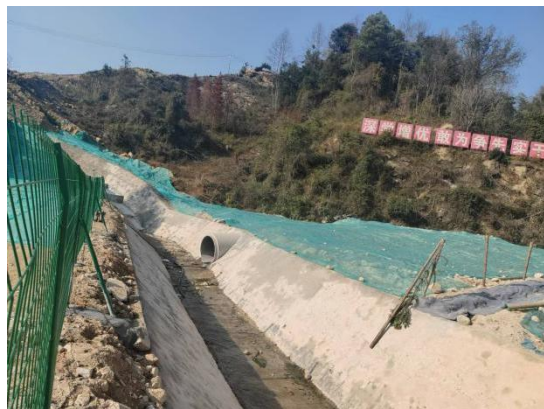
排土场西侧截水沟
