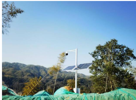
排土场视频监控设施
