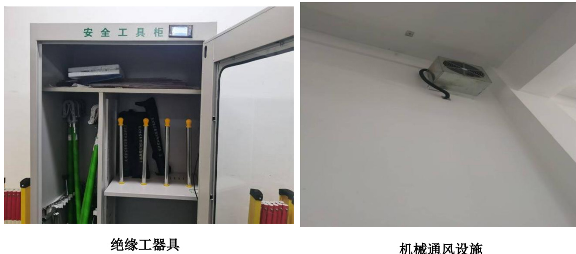
图 2.4-22 电气安全防护设施
