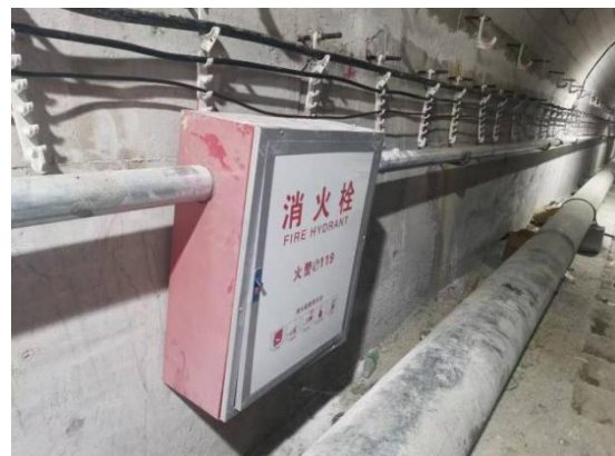
胶带斜井内消火栓
