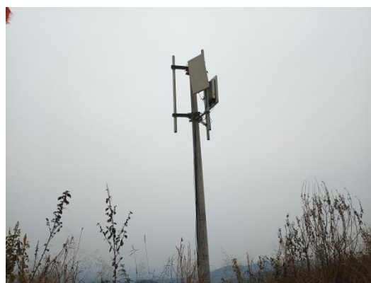
5G LTE 专网通信网络基站
