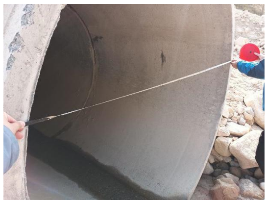
现场实测管涵尺寸
