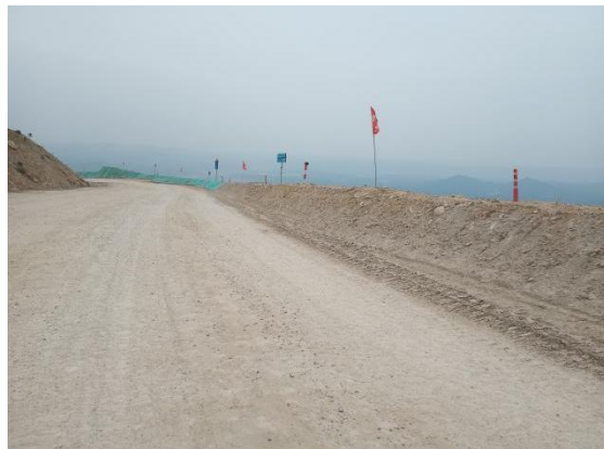
道路车挡及路桩
