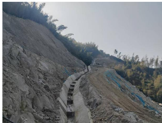
排土场东侧截水沟
