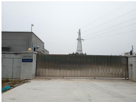
工业场地 35kV 总降变电站
