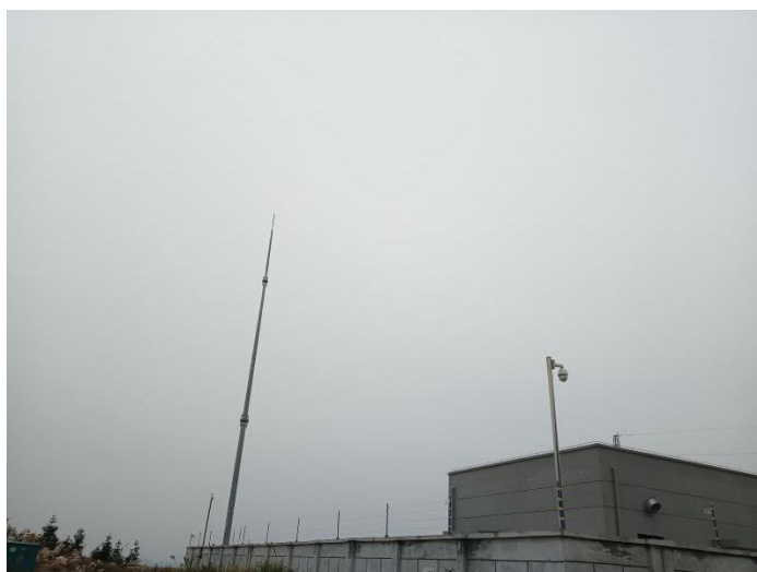
图 2.4-23 35kV 变电站防雷设施
