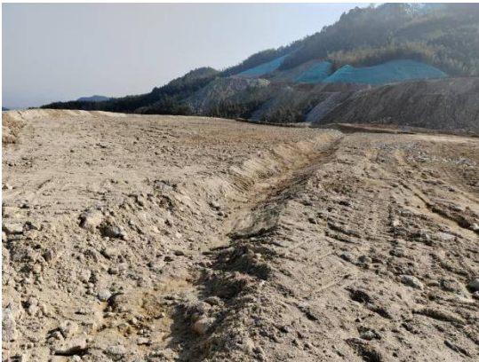
排土场平台排水沟
