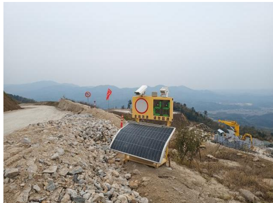
运输道路测速装置
